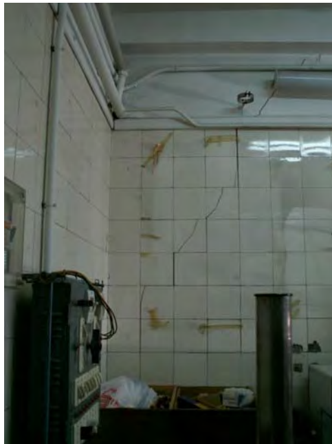
Fisuras debidas a la deformabilidad.
