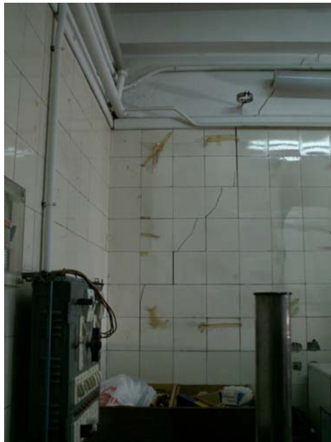
Fisuras debidas a la deformabilidad.
