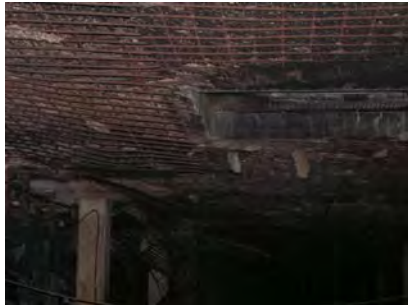
Daños por Incendio.
