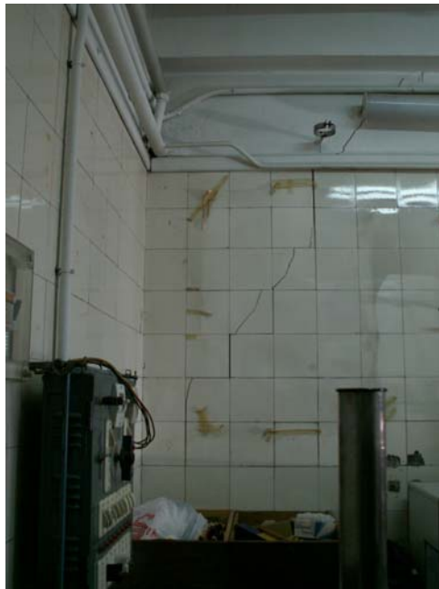
Fisuras debidas a la deformabilidad.
