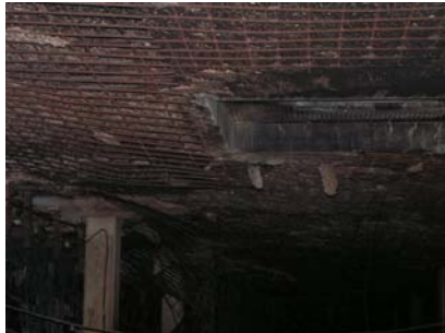
Daños por Incendio.
